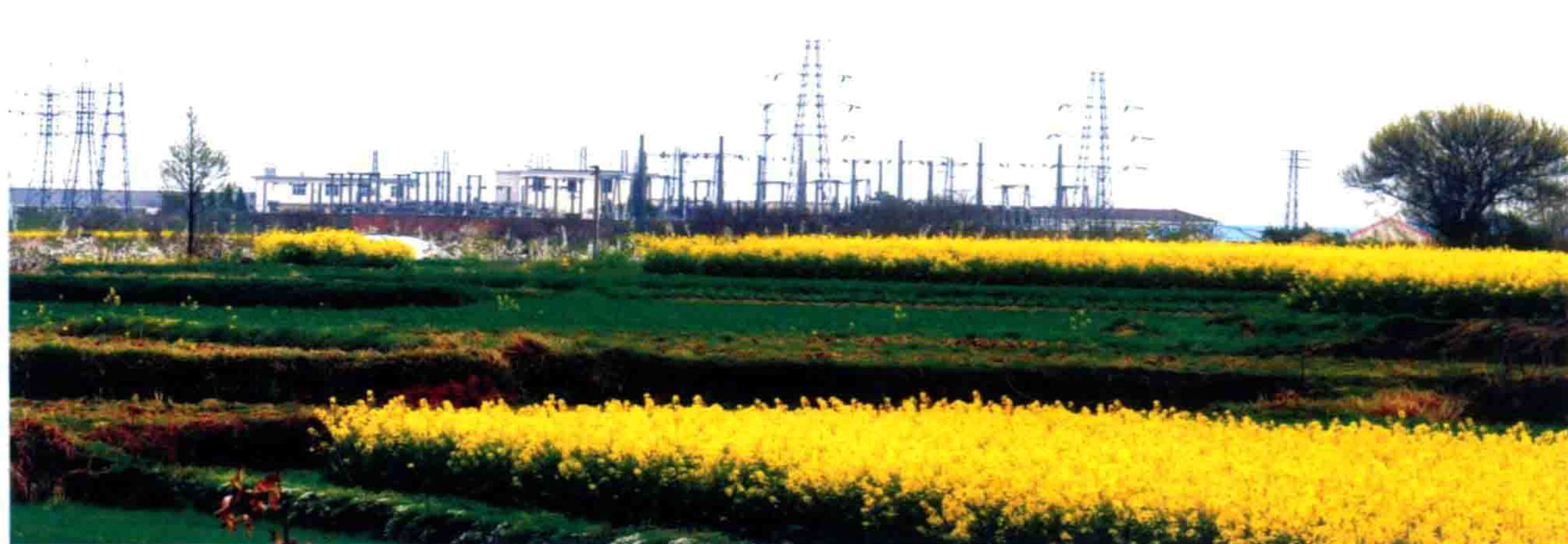
固城秀山变电站
