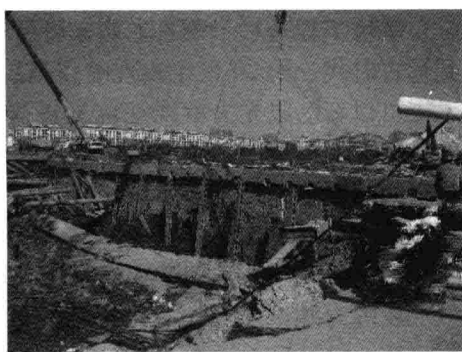
图1-4 杭州地铁基坑塌陷
