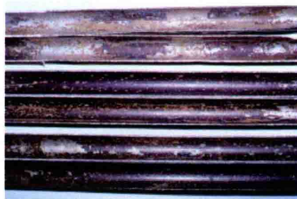
图4-28 管内表面膜剥落情况（97页）
