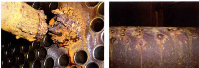
图4-36 凝汽器水室拉筋断裂（99页）
