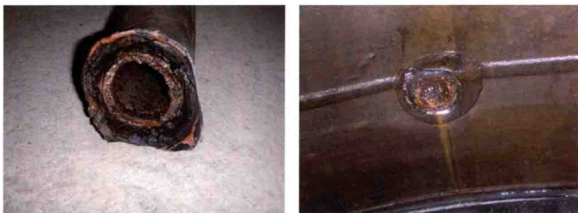
图4-37 凝汽器水室格栅管断裂（99页）
