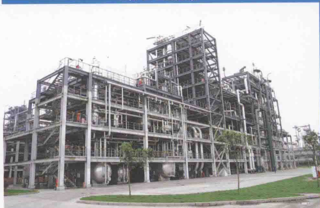
有机化工生产装置
