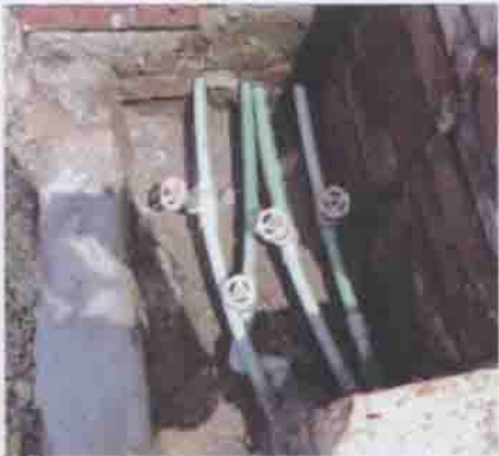
药肥水一体化 输水管道
