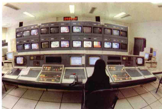
浙江有线电视台播控机房
