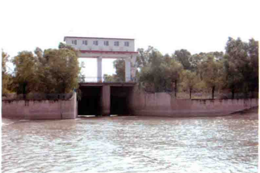
乌裕河泄水闸
