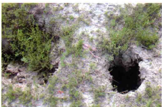
分散土冲蚀孔洞
