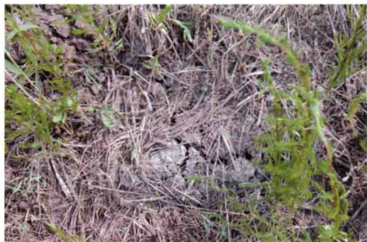
东城水库供水泵站北坡裂缝
