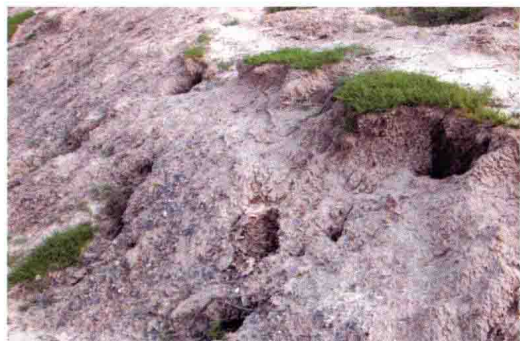
分散土对背水坡破坏
