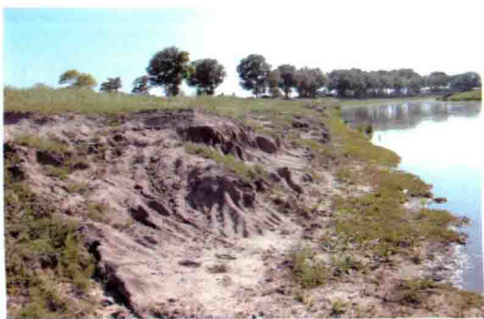
分散土破坏渠堤
