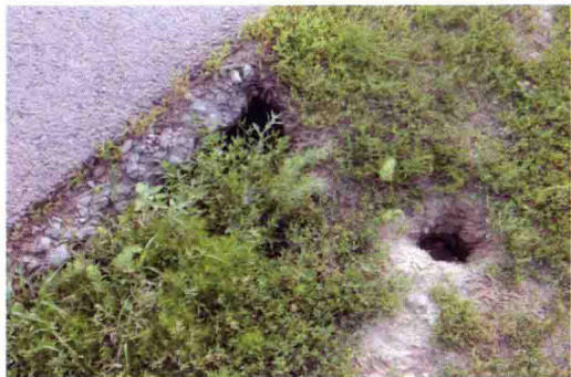
分散土在堤坝上破坏空洞
