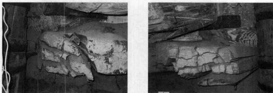
(a) 普柏枋南面端头残损现状
