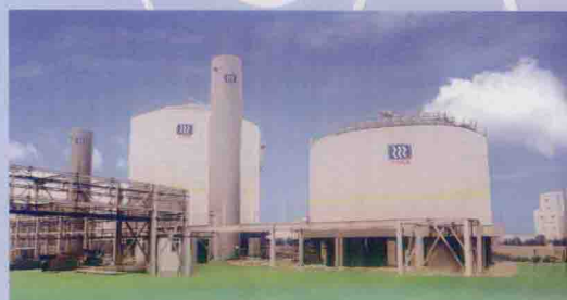
5000m³低温液体贮槽
