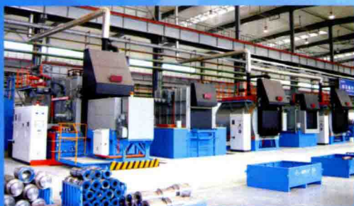
可控气氛密封箱式多用炉生产线
