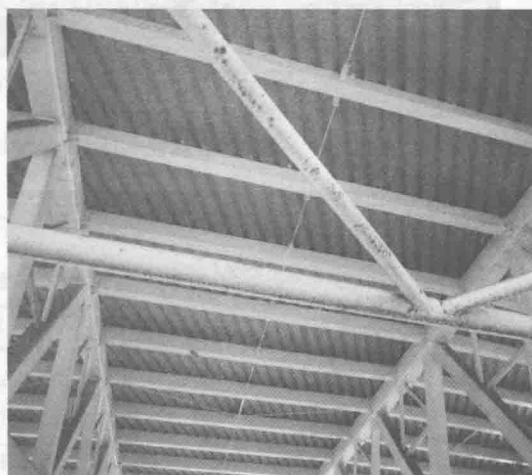
图 1.2-2 钢桁架杆件锈蚀
