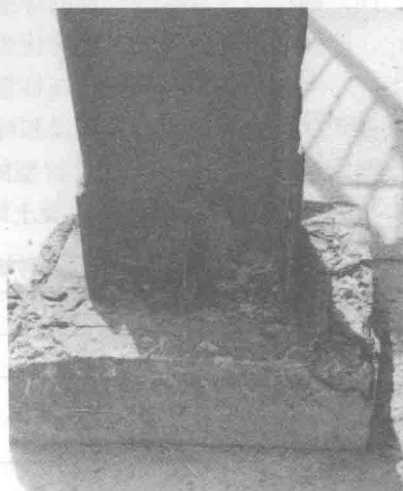
图 1.2-4 柱脚缀板腐蚀
