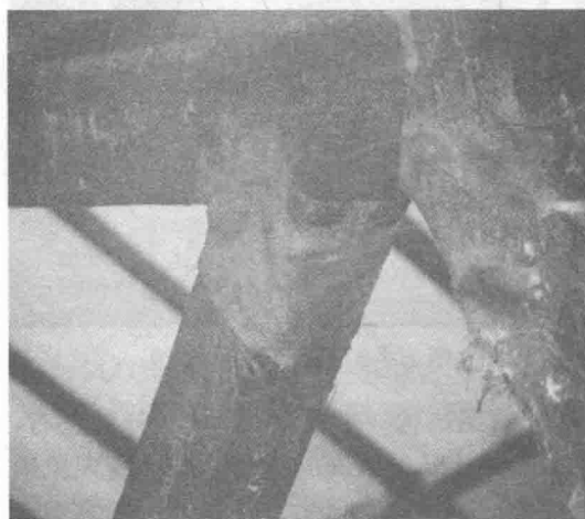
图 1.2-7 某工程屋盖结构杆件腐蚀
