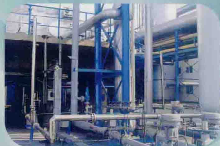
LNG 等低温液体输送管道
