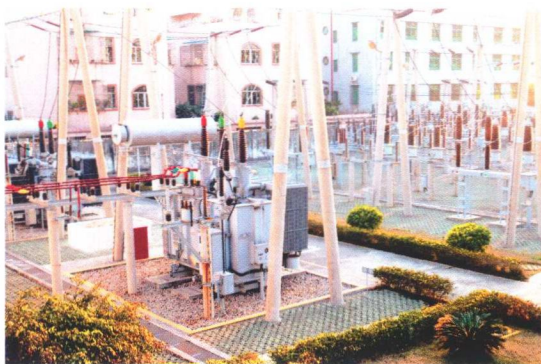
110 千伏澄海变电站（曾建一摄）
