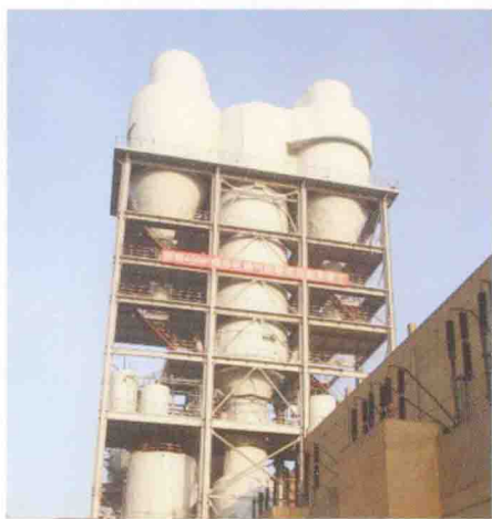
邯钢 400m 2 烧结机 CFB 法脱硫
