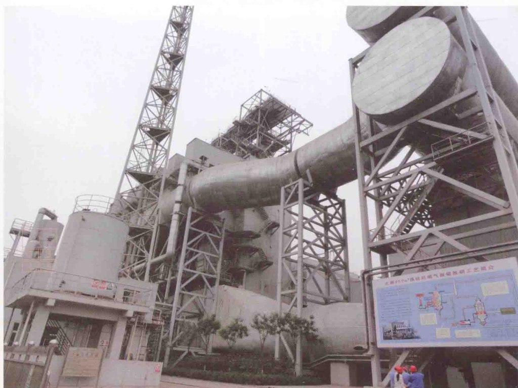
太钢 450m 2 烧结机活性炭法脱硫脱硝
