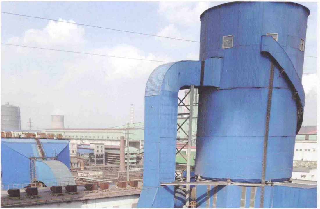
鞍钢 328m 2 烧结机 SDA 法脱硫
