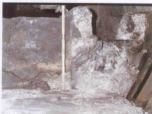
图6-26 在边缝中，大量电解质和金属通过收缩裂缝（表面被冷却的电解质和金属覆盖）渗透，导致阴极的破损 槽寿命5d
