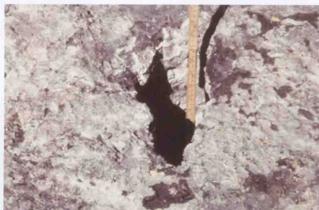
图6-10 一个预热裂缝横跨了一个底部阴极炭块的宽度，电解槽从此处渗漏，槽寿命856d
