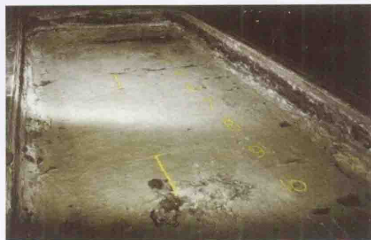
图6-7 破损电解槽阴极中的预热裂缝（在底部炭块5号和9号处）
