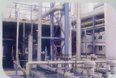
LNG 等低温液体输送管道
