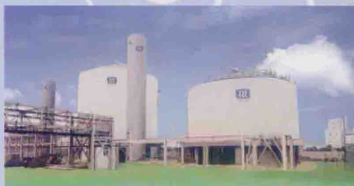
5000m 3 低温液体贮槽
