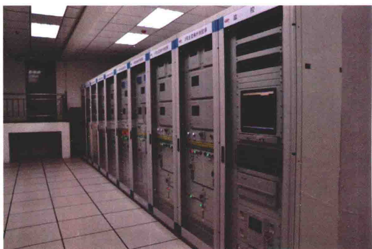
牵引变电综合自动化 (SCADA)系统
