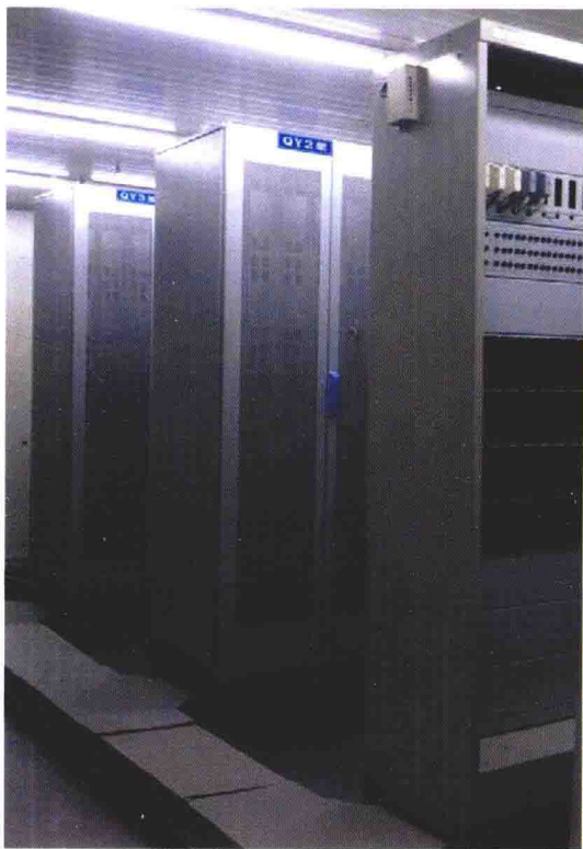
信号中继站箱房设备
