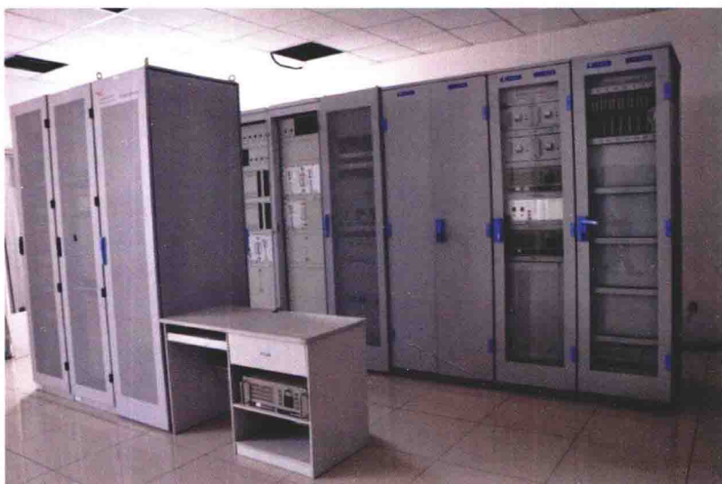
高邑西站信号机械室微机联锁和列控设备
