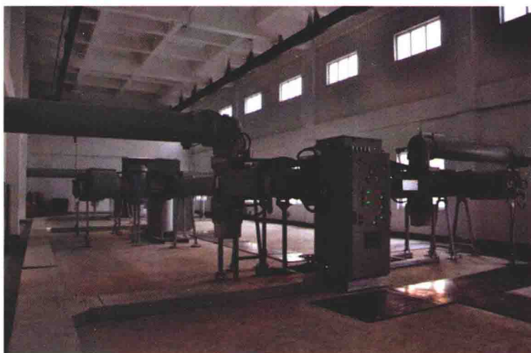
石家庄枢纽 110 kV 变电所高压设备
