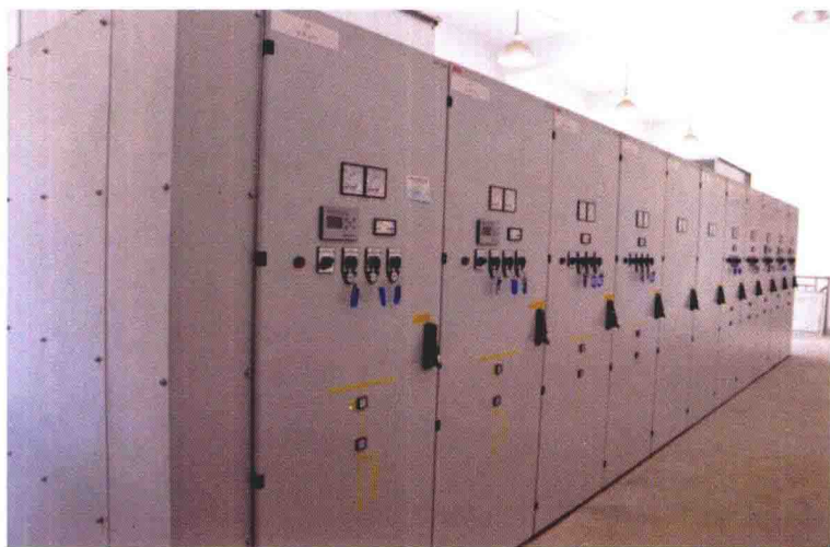
牵引变电所 GIS 高压开关柜
