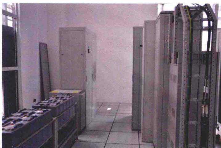
中间站通信机房 GSM-R、10G、622M 传输设备
