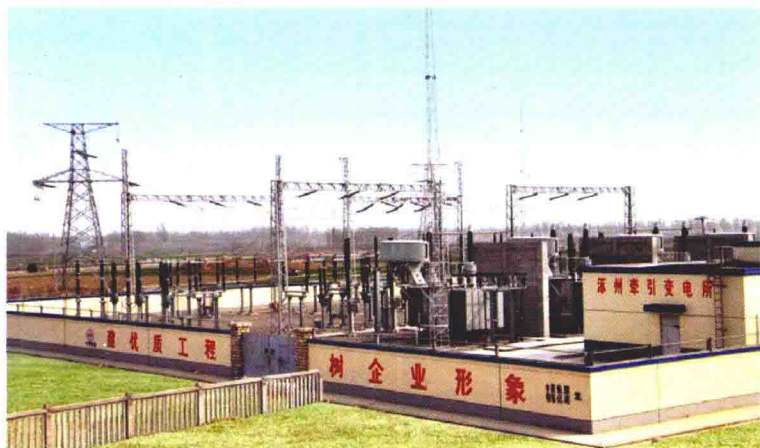
涿州东牵引变电所全貌
