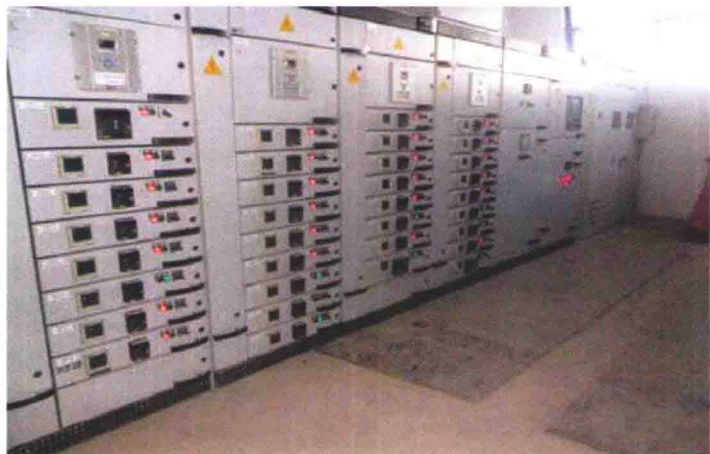
10/0.4 kV 变电所供电低压开关柜
