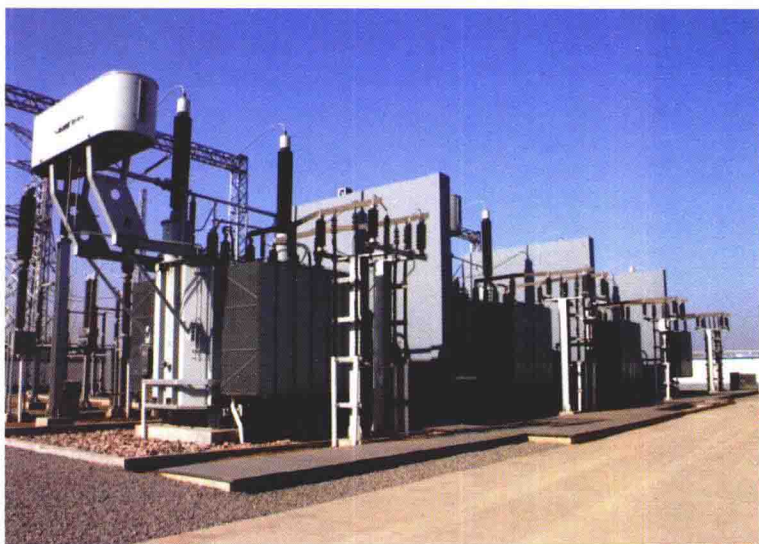
涿州东牵引变电所局部 (AT 单相接线牵引变压器)
