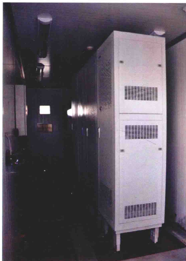
区间通信基站箱房 GSM-R、622M 传输设备
