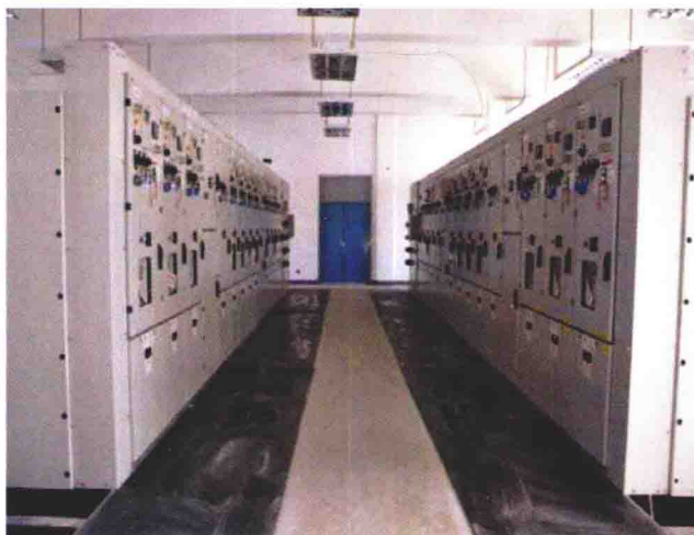
10 kV 高压环网开关柜
