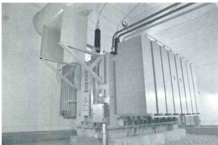
石家庄枢纽 110 kV 变电所变 电设备
