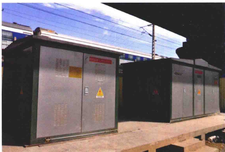
信号中继站 10 kV 箱式变电站
