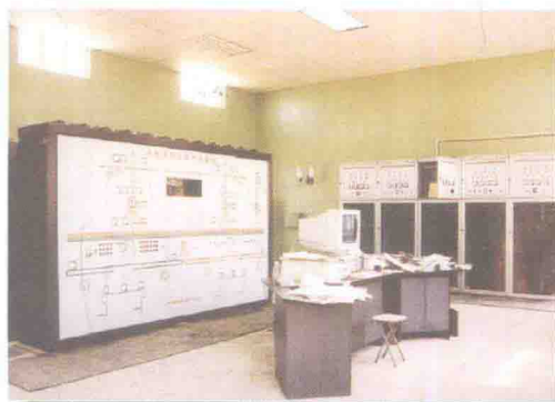
百色牵引变电所总控制室
