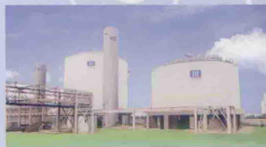
5000m 3 低温液体贮槽
