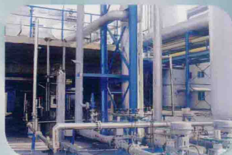
LNG 等低温液体输送管道
