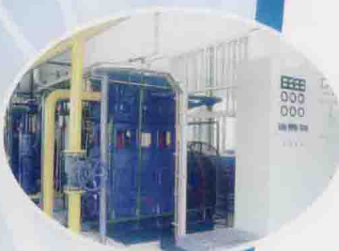
550m³/h 氧压缩机 550m³/h Oxygen Compressor
