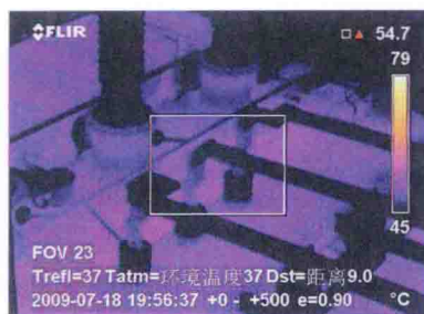
图1-8 检修后2009年7月18日 变压器低压侧套管铜铝过渡线夹 红外热像图
