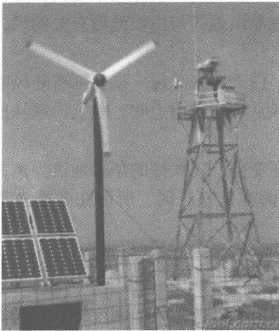
e) 野外通信设施自备风力发电装置
