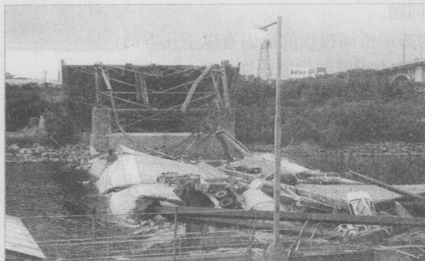
图 1-2 密西西比河大桥引起的桥梁坍塌事故
