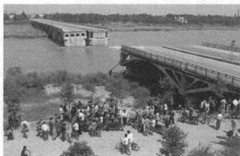
图 1-2 三渡水大桥倒塌
