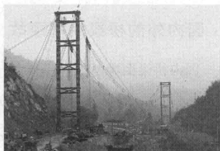
图 1-3 珍珠大桥倒塌遗址
