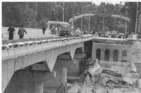
图 1-11 呼兰河大桥倒塌现场
