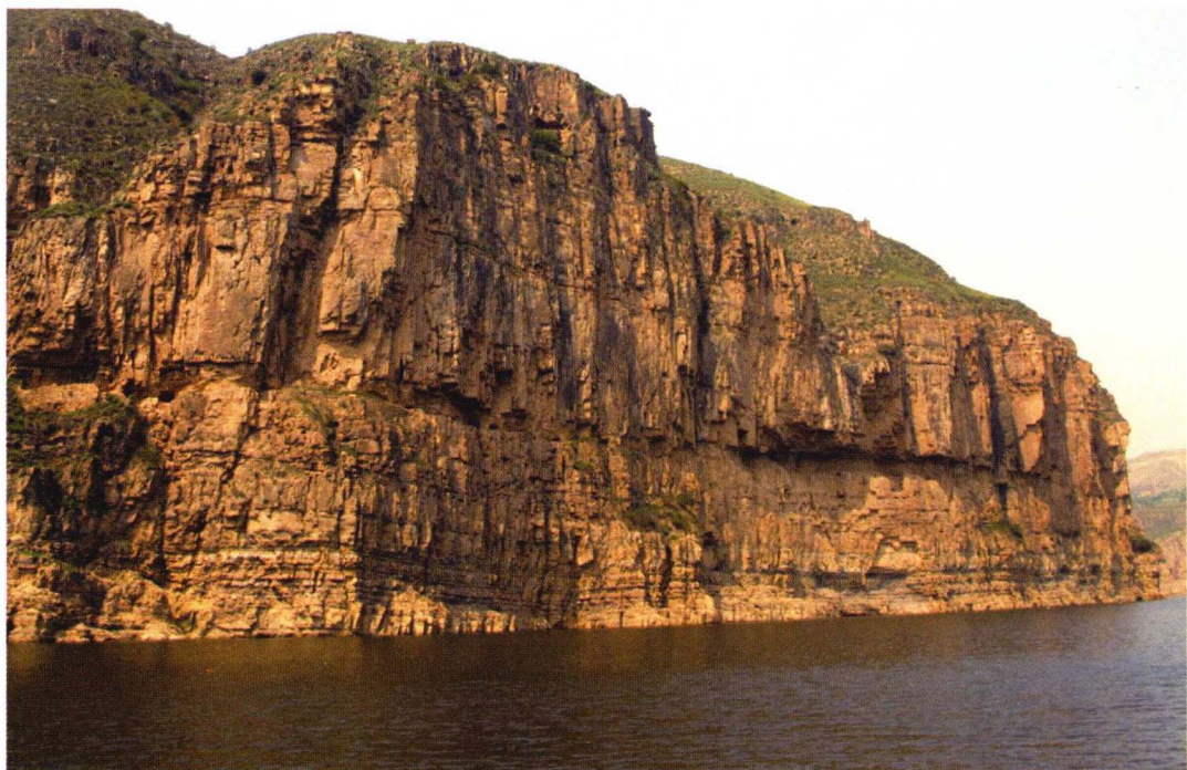
图18 山西偏关县的黄河栈道,因库水侵蚀了山岩,崖道的下部崩塌了
