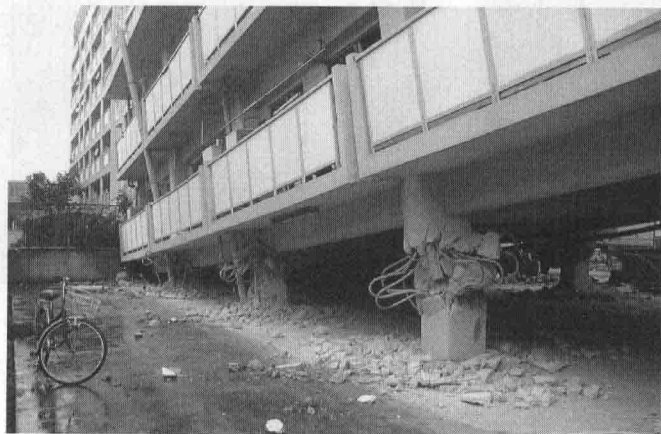
(a) 底层柱子强度明显不足引起的破坏
