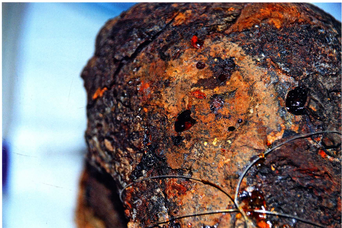
图 1.11 点腐蚀、水珠状液体渗出
