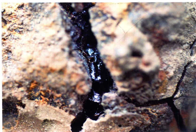
图 1.13 缝隙内部水泡状腐蚀物
