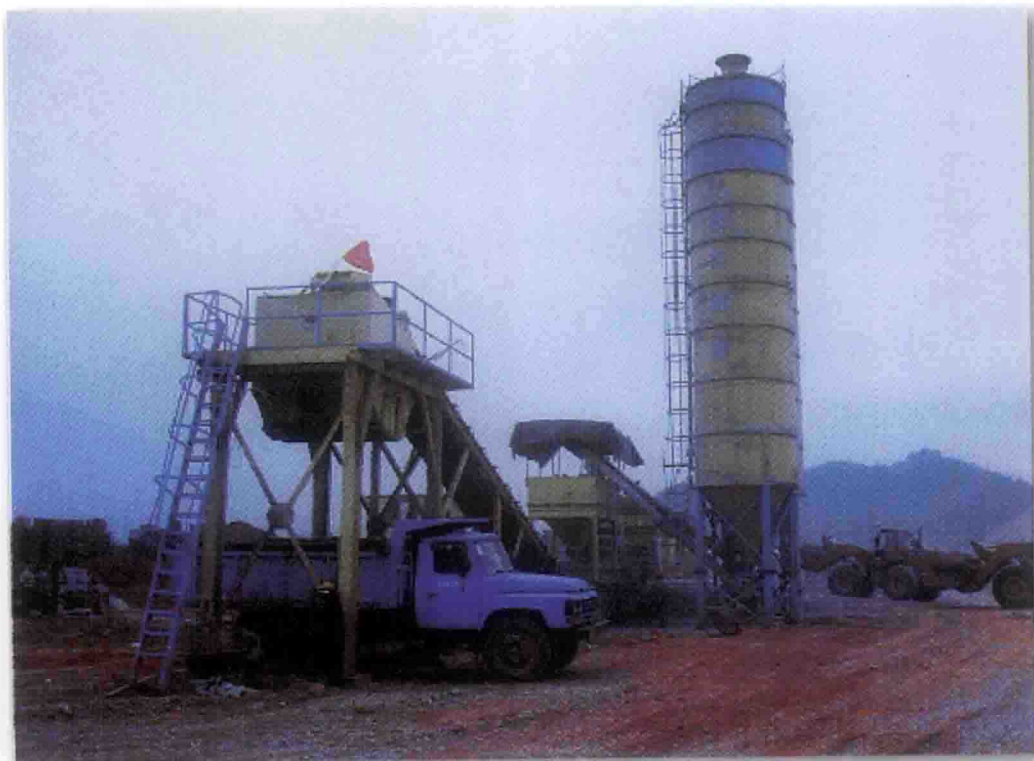
现代路桥总公司:500吨水泥稳定土拌和楼
