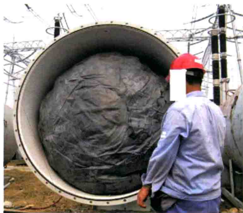
图 1-11 胶囊式储油柜内部
