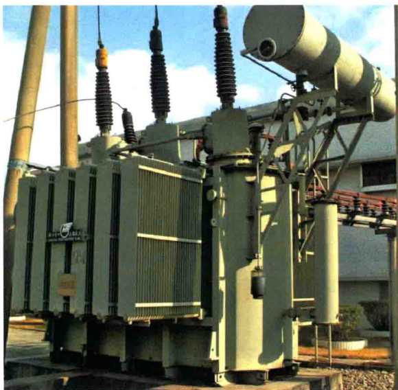
图 1-1 变电站中的变压器
