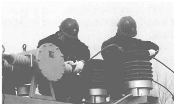
图 1-1 检修、维护电气设备
