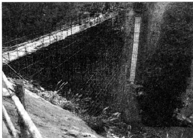
图 1-1 小尖山大桥突然发生支架垮塌事故
