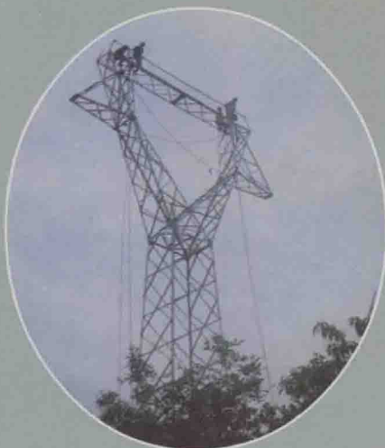
贵州天顶 220 kV 输电线路中猫头型铁塔
