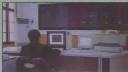
京九铁路津霸线行车指挥自动化系统调度集中监控室
