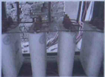
! 配电室建筑物的墙体结构不符合建筑要求
