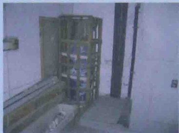
! 配电柜旁堆放无关物品
