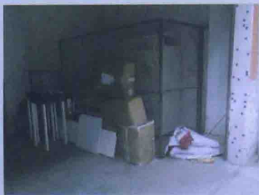
! 配电柜栅栏处堆放物品
