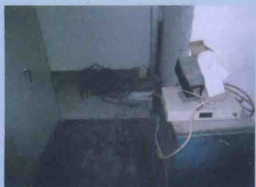
! 配电柜堆放电气设备及导线
