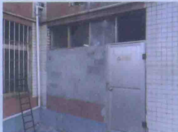
! 配电室为其他房间拼凑改装
