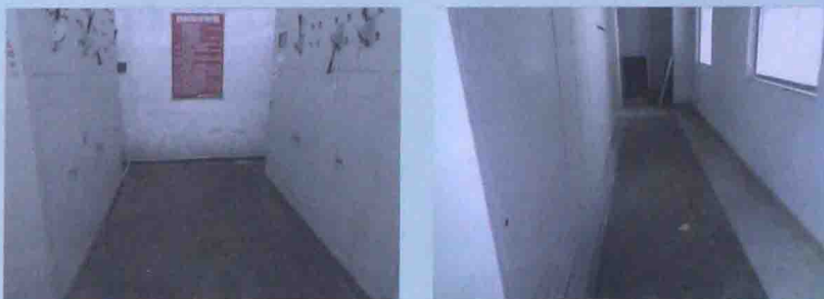
正规配电室的配电柜
