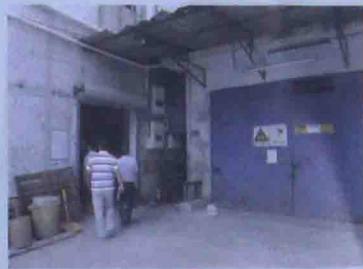
! 配电室配置在临时建筑物内
