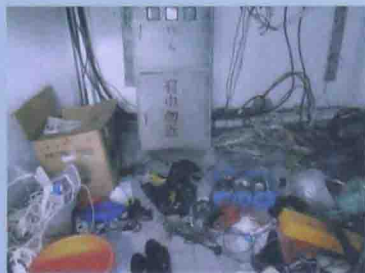
! 配电柜周围堆放杂物
