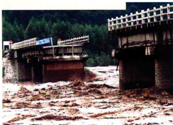
8月13日，浑河上游苏子河段的东南杂木大桥坍塌，交通中断
