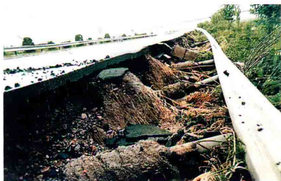
沈大高速公路28~29千米处被洪水淹没冲坏
