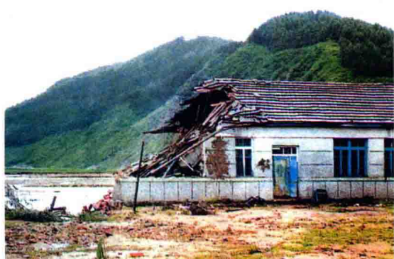
新宾县下营子镇中学校舍被冲毁
