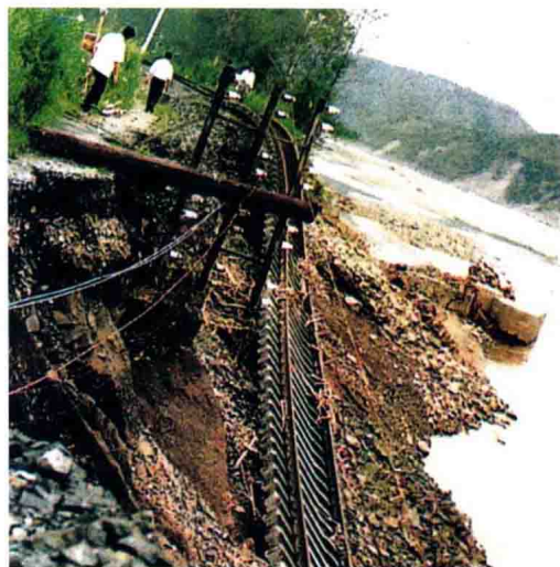
沈吉线铁路106千米处路基被洪水冲毁
