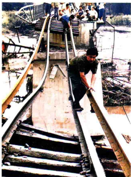
沈丹线16千米处铁路桥被洪水冲毁
