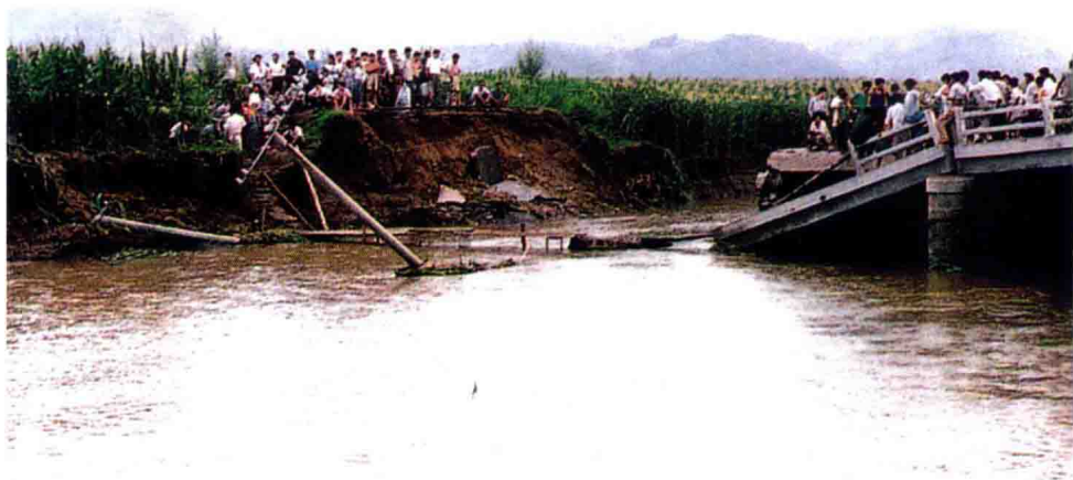
铁岭县公路桥被洪水冲毁
