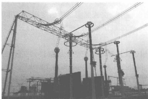
图 1-1 我国 1000kV 示范工程特高压变压器
