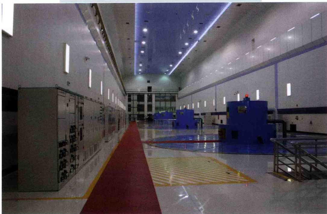
百色水利枢纽运行中的地下厂房
