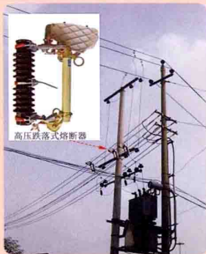
高压跌落式熔断器
