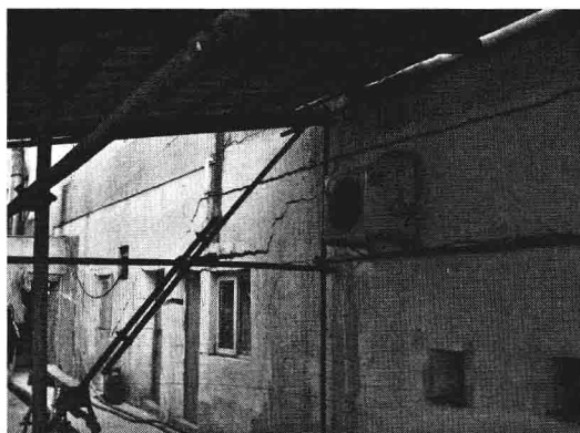
图1-3 基坑渗漏造成周边建筑开裂
