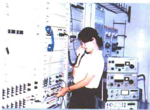
变电站控制室
