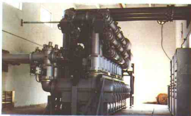
红山进口设备变电站
