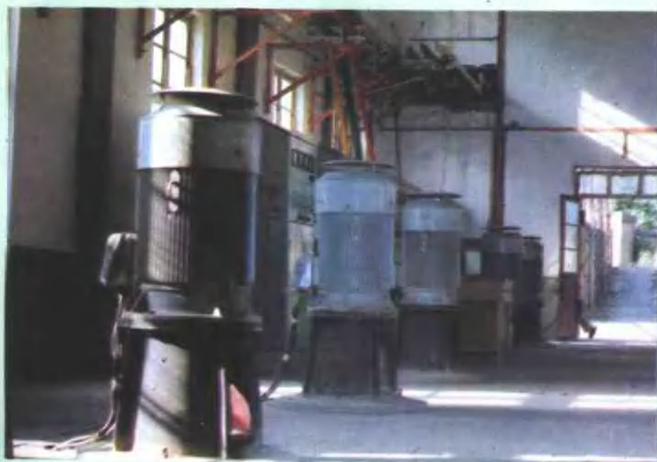
子牙扬水站内景
