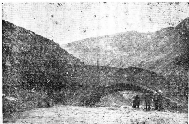
图1-2 被大石块击毁的泥石流渡槽
