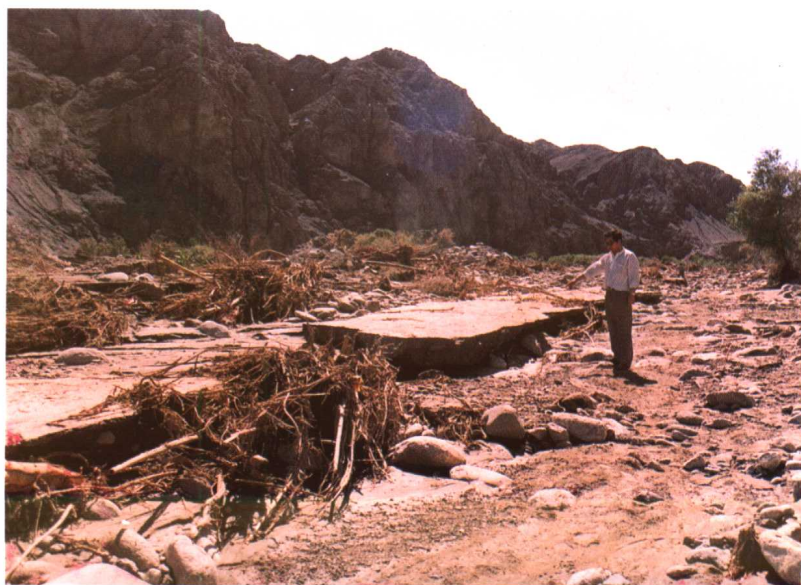
新疆阿拉沟泥石流冲 毁的公路及洪峰过后 的遗留物 新疆防办供稿
