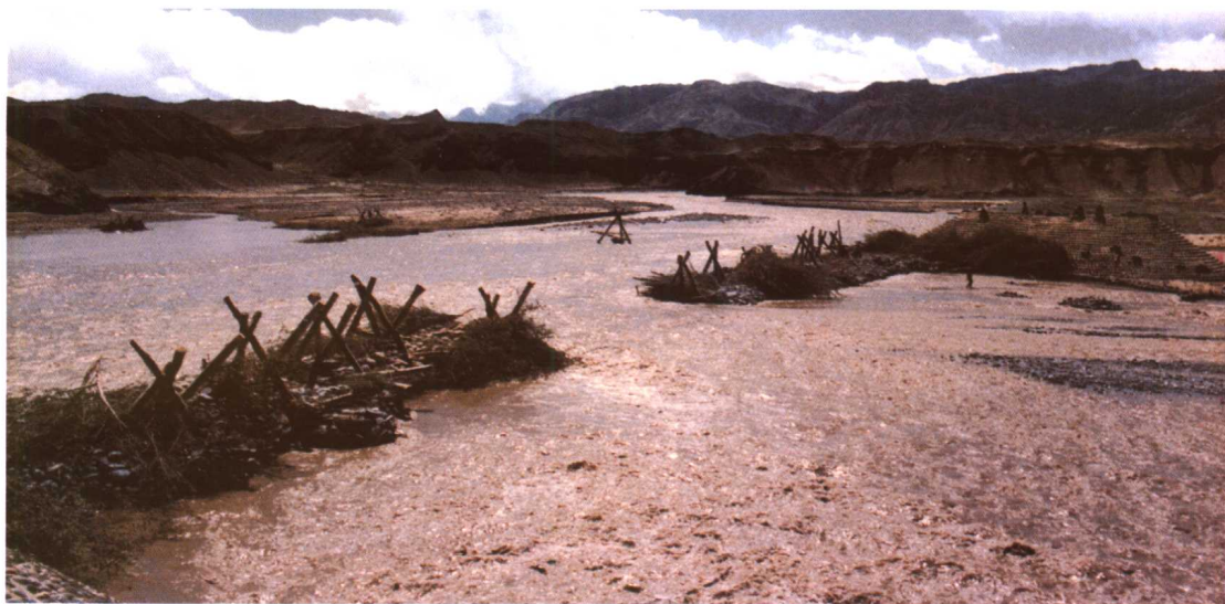
山洪冲毁新疆英吉沙县苜华里溢洪堰 吴定法摄
