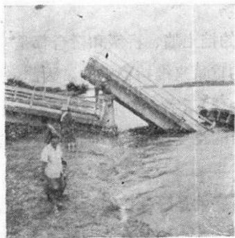
图 6 施工质量不良的桥梁在地震时遭到了严重破坏
