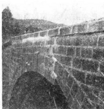
图3 地基不良的石拱桥,经历10度地震后拱圈斜向错断,破坏比较严重
