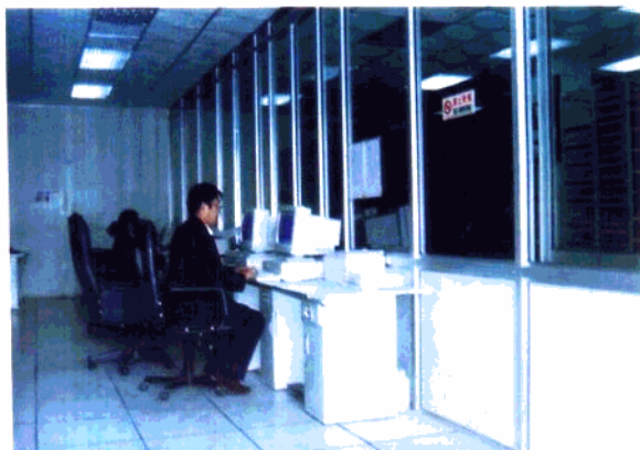
市邮电局程控机房终端控制室
