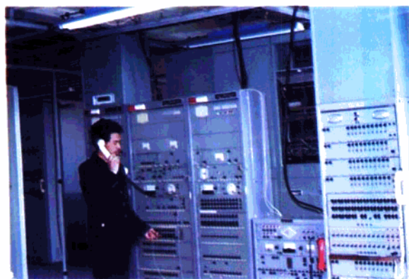
市邮电局程控电话机房
