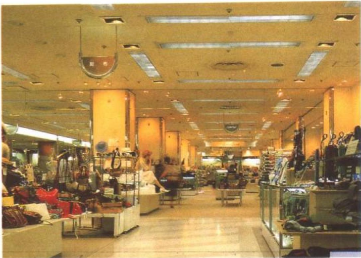
图1·1 基础照明（平均照度）
