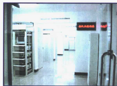
金汉王机房一角
