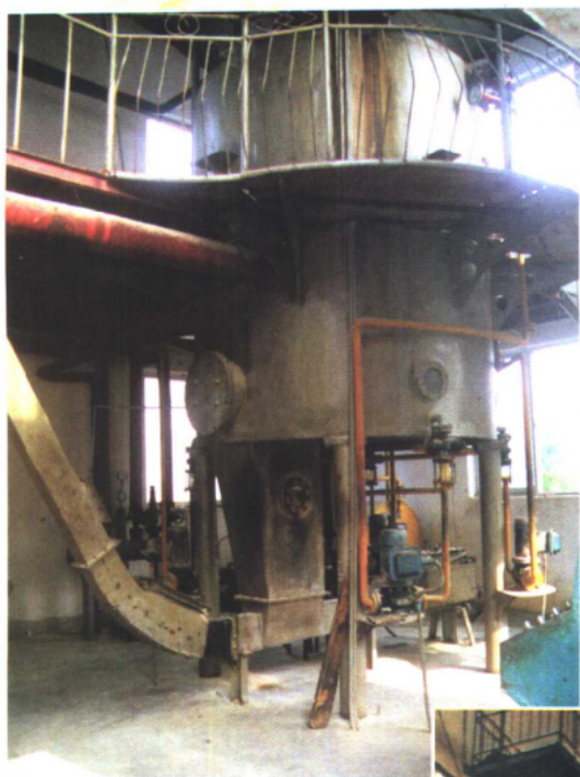
溶剂浸出法制油车间一角
