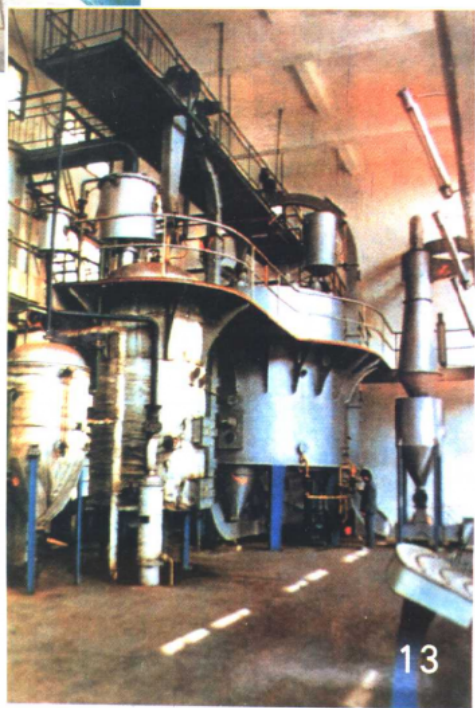
油脂浸出车间设备
