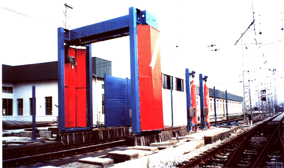
广州地铁一号线车辆段引进国外先进设备——列车自动化洗车机
