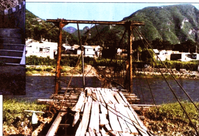
永定河洪水冲垮陈家庄吊桥
