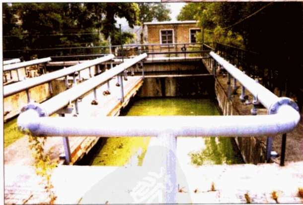
506厂污水处理设施
