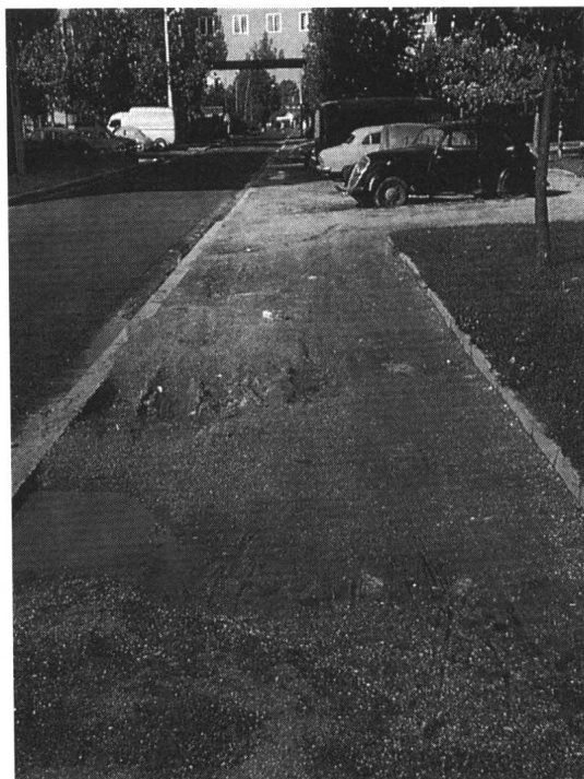
图1.05 因缺乏坡度和排水沟而毁坏的砾石地面
