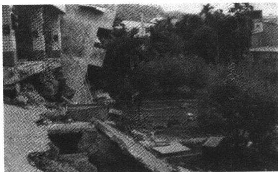
图 1.12 地基隆起导致建筑物破坏
