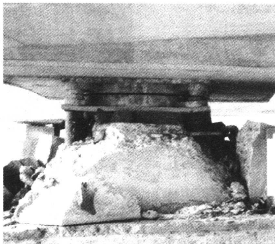
图 1.9 桥梁支座压碎
