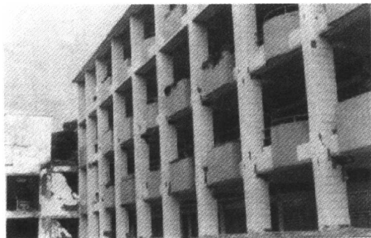
图 1.11 梁柱接头破坏
